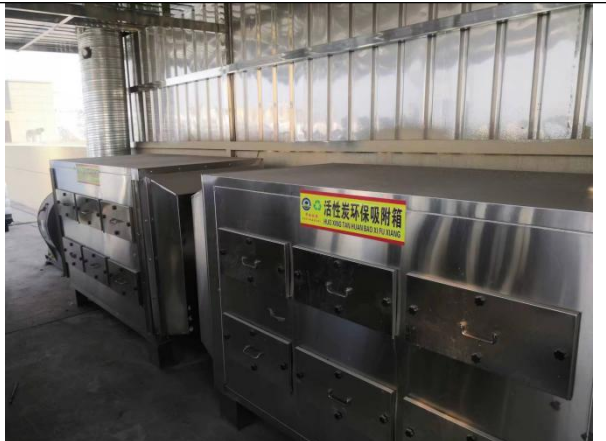
吹膜制袋印刷废气处理设施
