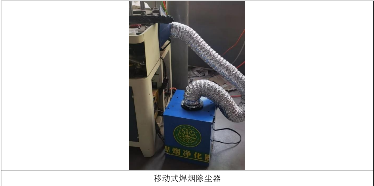
图 4-2 废气收集及处理设施
