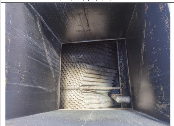
污水处理站填料
