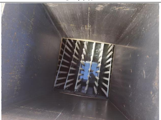
污水处理站填料
