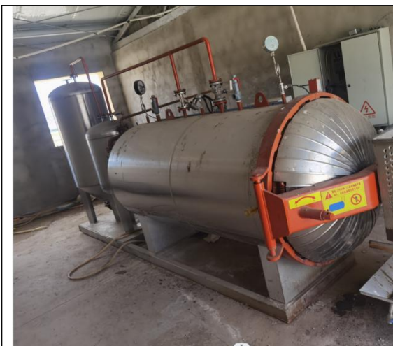
无害化处理设施
