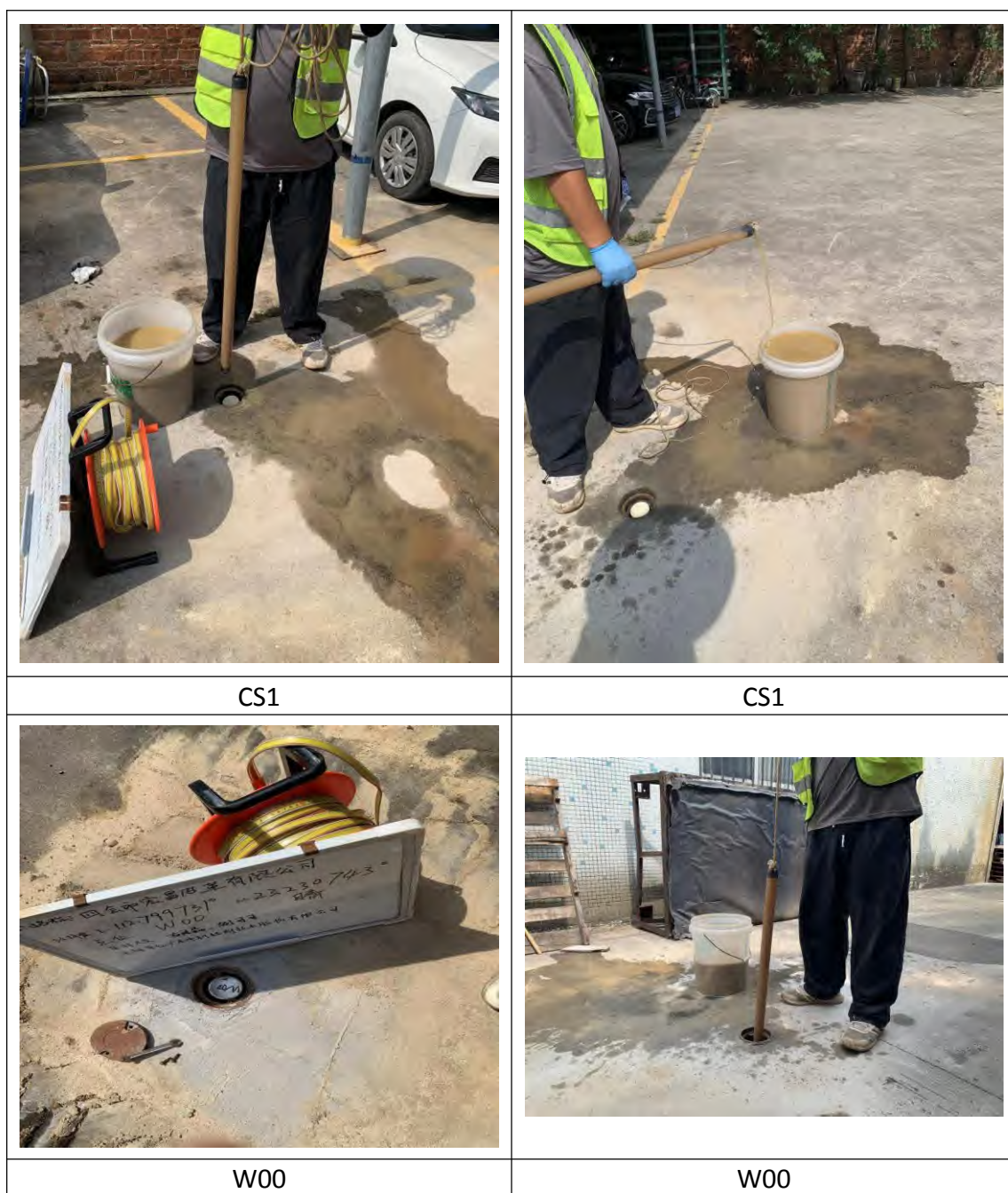
图 5.3-5 地下水洗井照片
