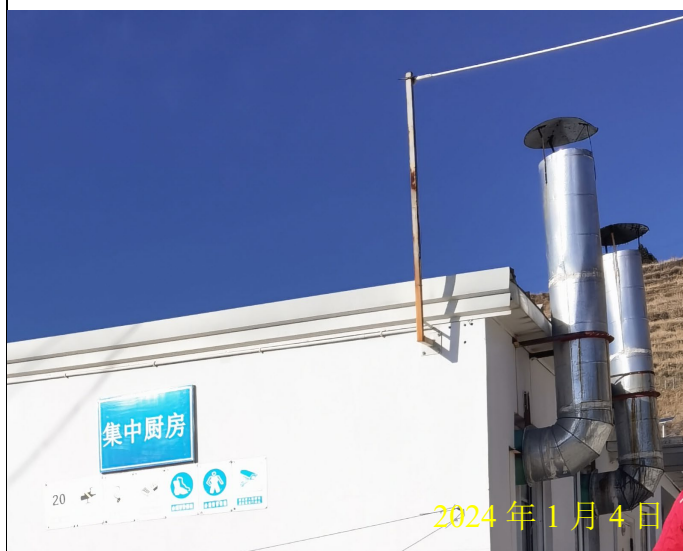
食堂厨房油烟排气筒
