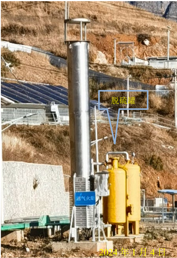
沼气火炬及沼气脱硫罐设施
