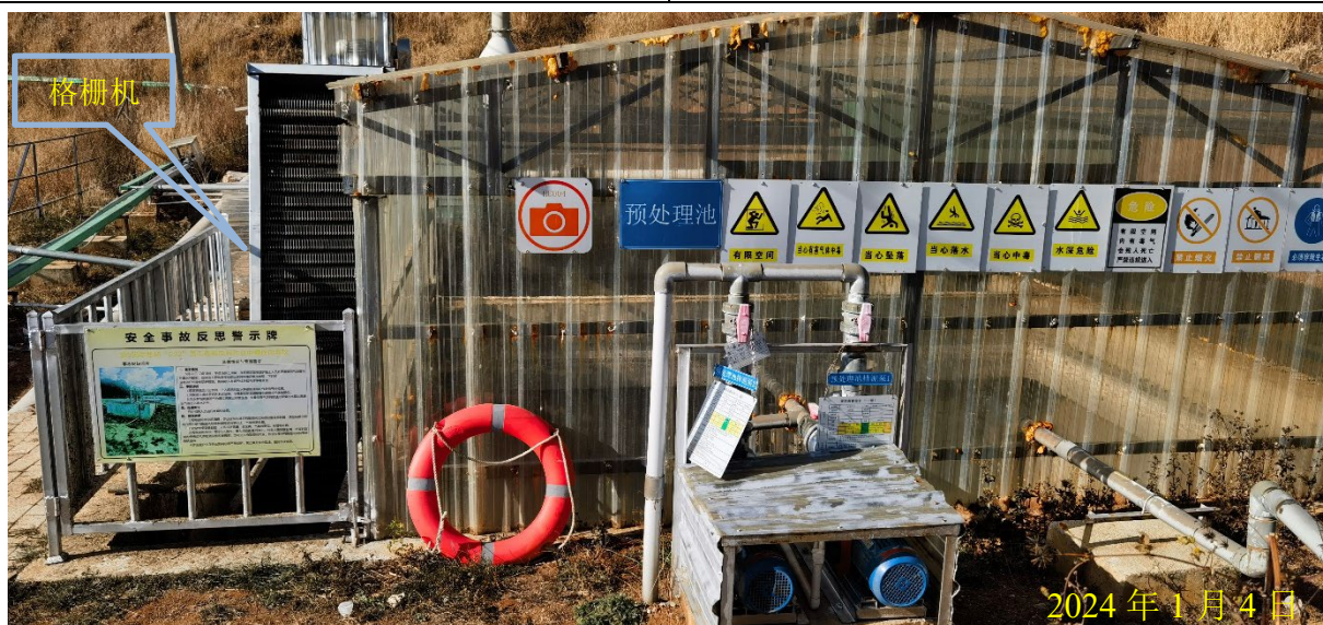
污水集水池（预处理池）排泥泵、标识牌、密闭罩及格栅机
