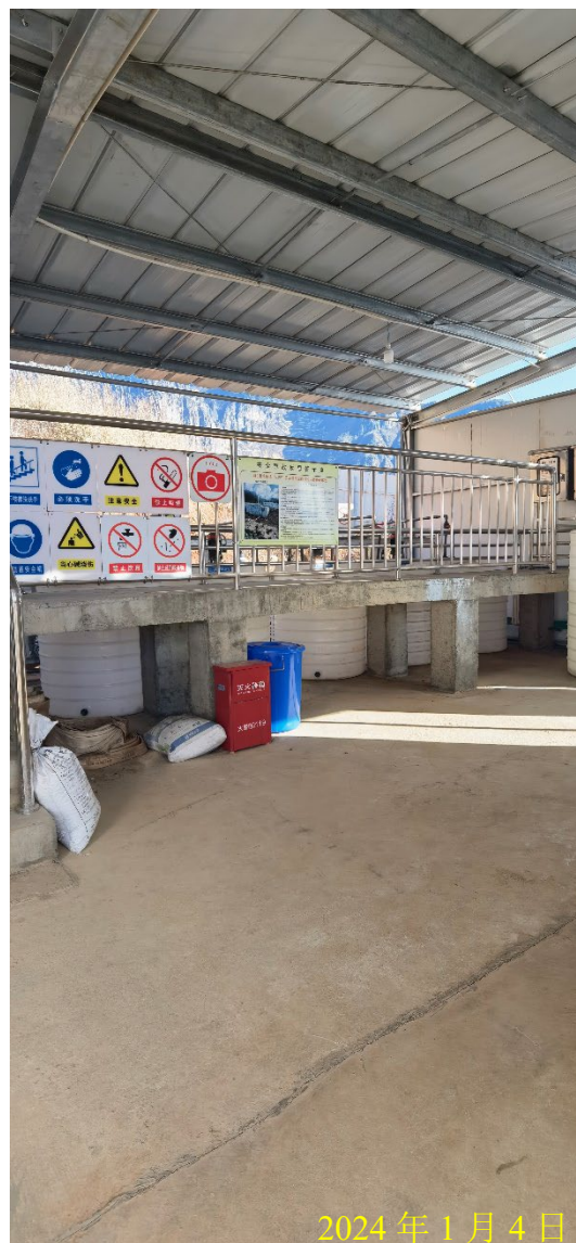
深度处理池加药棚及标识牌
