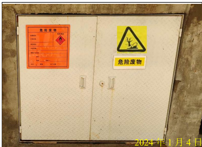
危废暂存间标识
