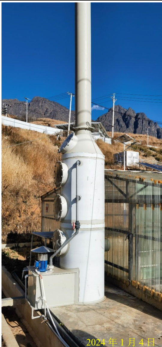
污水收集池（预处理池）除臭装置
