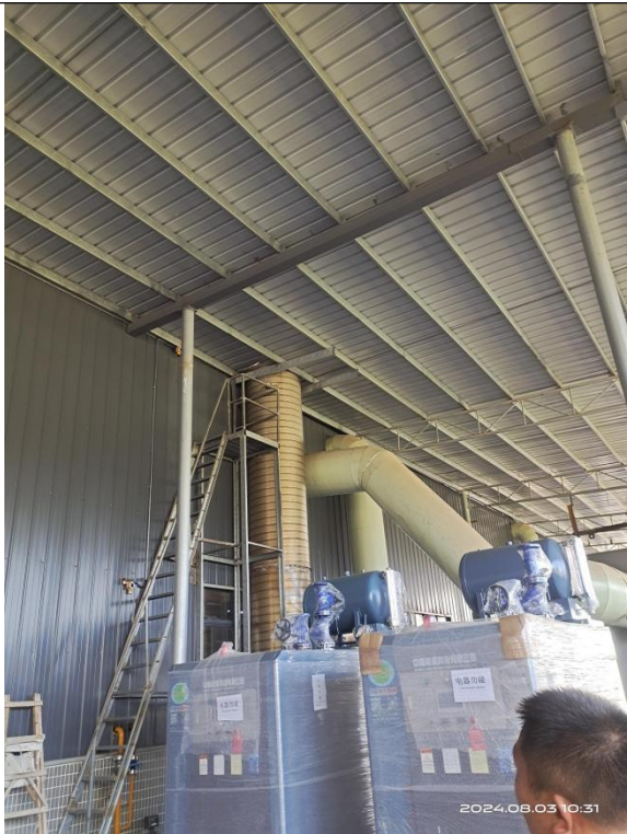
DA001 排放筒采样口、采样平台
