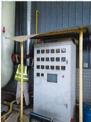
DA001 RTO 炉废气处理前采样口
