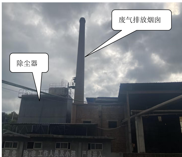
锅炉废气处理设施
