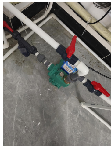
采样泵、手工采样口
