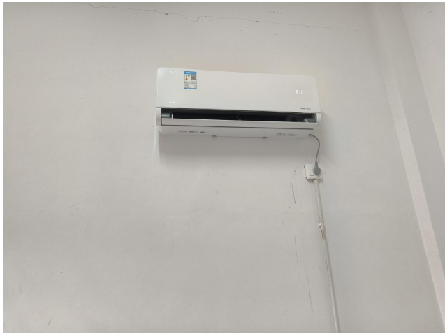
设备站房空调
