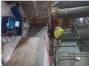
池炉废气处理前采样口
