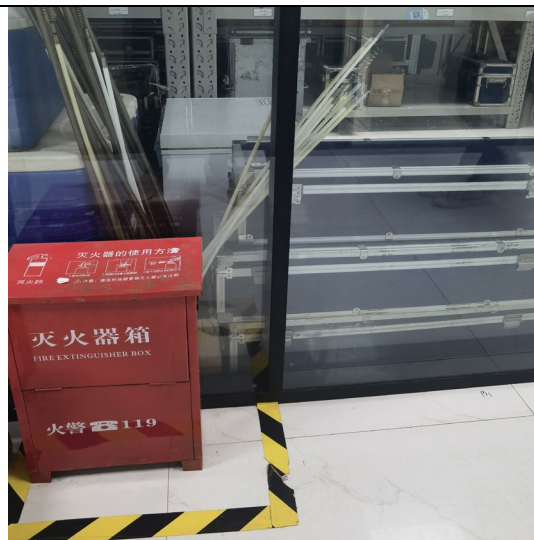
依托原有消防设施
