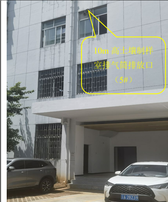
10m 高土壤制样室排气筒排放口（5#）
