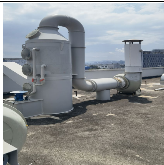
扩建无机废气碱喷淋处理装置及 23m 高无机室 2#排气筒
